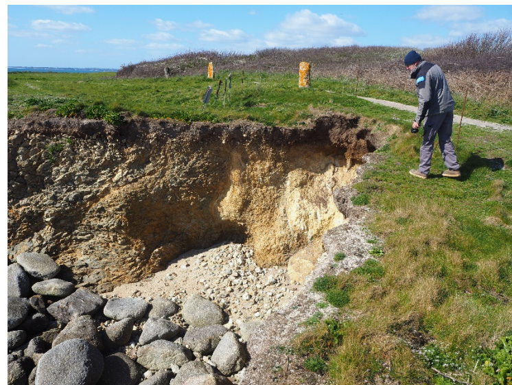
Illustration 16 - Veille sur les risques d'éboulements en bordure de sentier côtier, Trégunc, 2019 © Axel Robin
