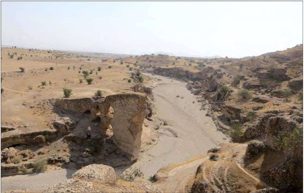
تصویر ۵: بازمانده پل شکسته شور روی رودخانه شور-دالکی، در راستای جاده سرمشهد-جره. Fig. 5: Remains of the Šekasteh bridge on the Sar Mašhad- Jereh road, over the Šur-Dālakī River.
