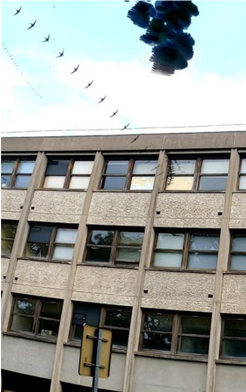
Figure 12 : Entrée de nid entre 2 fenêtres (Bâtiment 13 Nord-Ouest)
